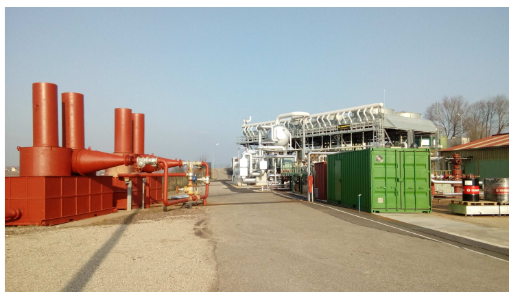
Photo 15 – La centrale géothermique de Soutz-sous-Forêts en Alsace du nord avec ses installations de surface (ADEME)
