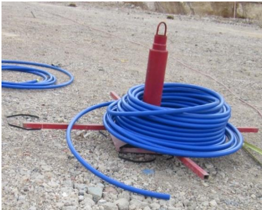
Figure 47 : Tubes échangeurs en PEHD (Géothermie-Professionnelle/Pinto)
